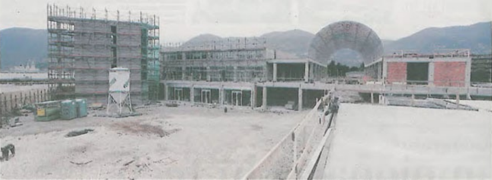
I lavori per ultimare le opere a terra del porticciolo stanno procedendo a ritmo serrato. Da sinistra, il centro commerciale, la galleria e parte della zona parcheggi
